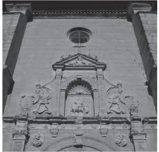
Figura 14 Detalle de soluciones de continuidad entre etapas de obra de la fachada sur de la iglesia de San Martín (Mota del Marqués, Valladolid), imagen de los autores
