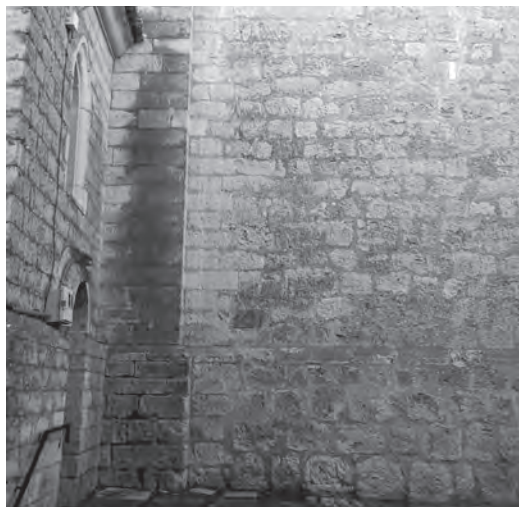
Figura 15 Detalle de soluciones de continuidad entre etapas de obra de la fachada norte de la iglesia de San Martín (Mota del Marqués, Valladolid), imagen de los autores
