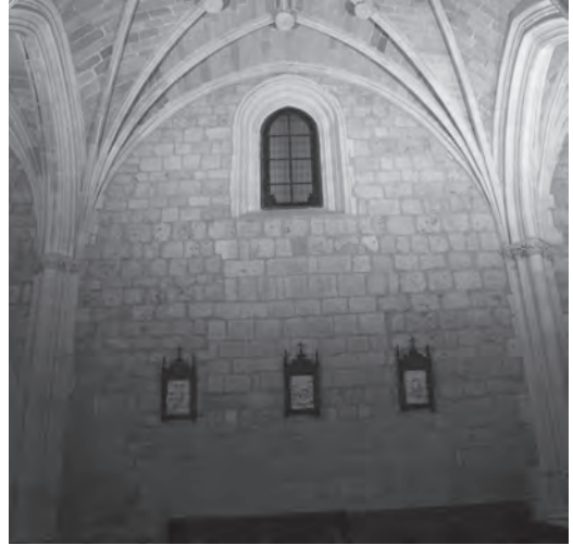
Figura 12 Detalle de soluciones de continuidad entre etapas de obra de la iglesia del convento de Nuestra Señora de la Merced (Burgos), imagen de los autores
