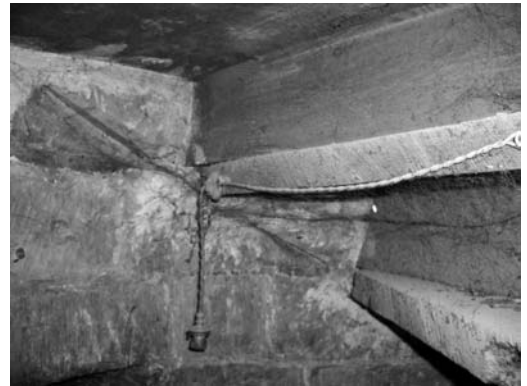
Figura 6 Pérdida de Volumen por fractura del peldaño en la sección de su unión con el muro (foto de la autora 2012)
