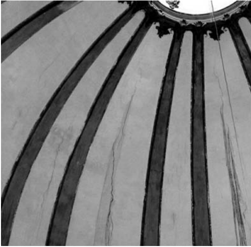
Figura 7 Agrietamiento de la cúpula (Archivo Parroquial de San Juan Bautista de Cox 1990)
