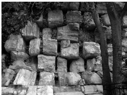
Figura 3 Detalle del paramento de aguas abajo de la presa de Muel, donde se observa la separación entre las piezas dispuestas a tizón
