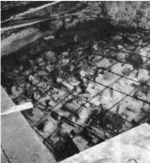
Figura 11 Tela metálica preparada para recibir el hormigón para la formación del cascarón (1970)
