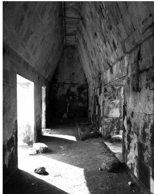
Figura 10 Interior de una de las estancias de la Casa de las Tortugas de Uxmal (Yucatán).
