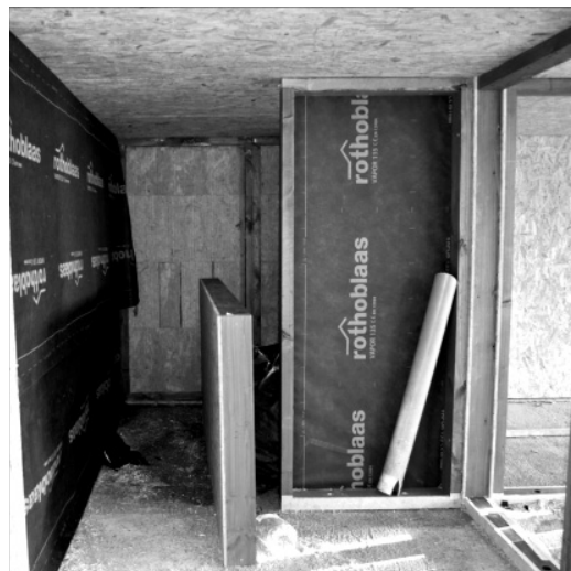
Figura 4. Paneles MATRYOSHKKA © en proceso de montaje. Se aprecian los marcos y tableros estructurales de OSB, el aislamiento incorporado en los cerramientos del fondo y la impermeabilización interior y de tabiques con lámina permeable al vapor ROTHOBLAAS © . Fuente: Ander de la Fuente
