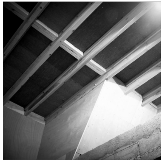
Figura 7. Forjado de grandes luces realizado con el sistema MATRYOSHKKA ® en la sala Boulder de Trapagaran (Bizkaia). Fuente: Víctor Araújo
