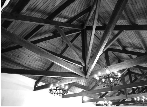
Figura 7 Imagen de la cubierta del cuartelillo del Montón, en Ferrol, de finales del XVIII. (fotografía del autor)
