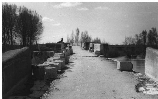
Figura 7 Fotografía de 1962 Detalle de los desperfectos en el pretil. AGA TOP 46 29 CA 19208
