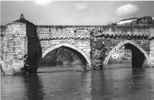
Figura 14 Falta de traba del tajamar desaparecido con el cuerpo de la Pila 7. AGA
