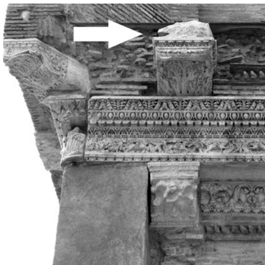
Figura 11 Soluzione angolare del ballatoio del prospetto principale: la caduta delle piattabande in mattoni ha reso visibili i blocchi di pietra sopra le mensole, in origine nascosti da una fodera laterizia
